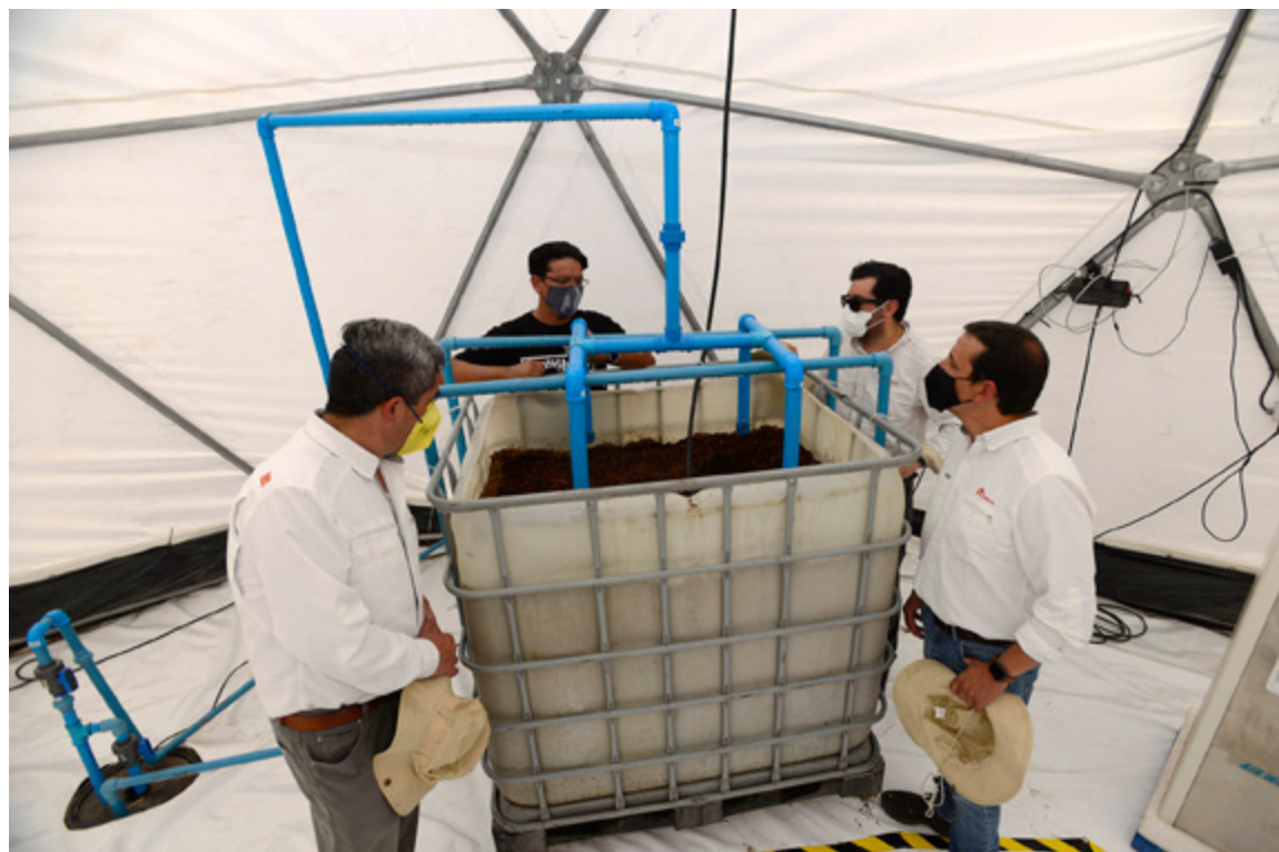
Proyecto Ciclo, sistema de procesamiento de agua instalado en el Liceo de Pica.
